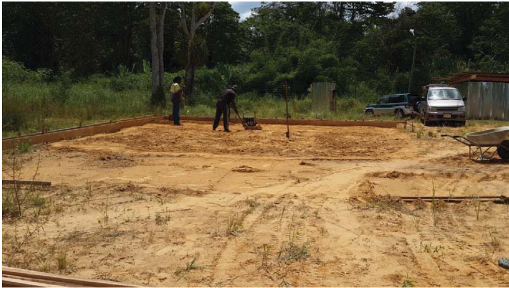
2014-09-17 – stampen maaiveld technische ruimte
